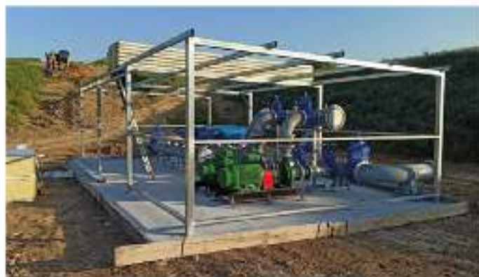
Estació bombament i filtratge per finca 370 Ha Estación de bombeo y filtraje para finca
