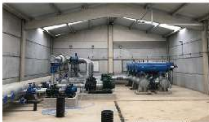
Estació bombament i filtratge per CCRR 550 Ha Estación de bombeo y filtraje para CCRR
